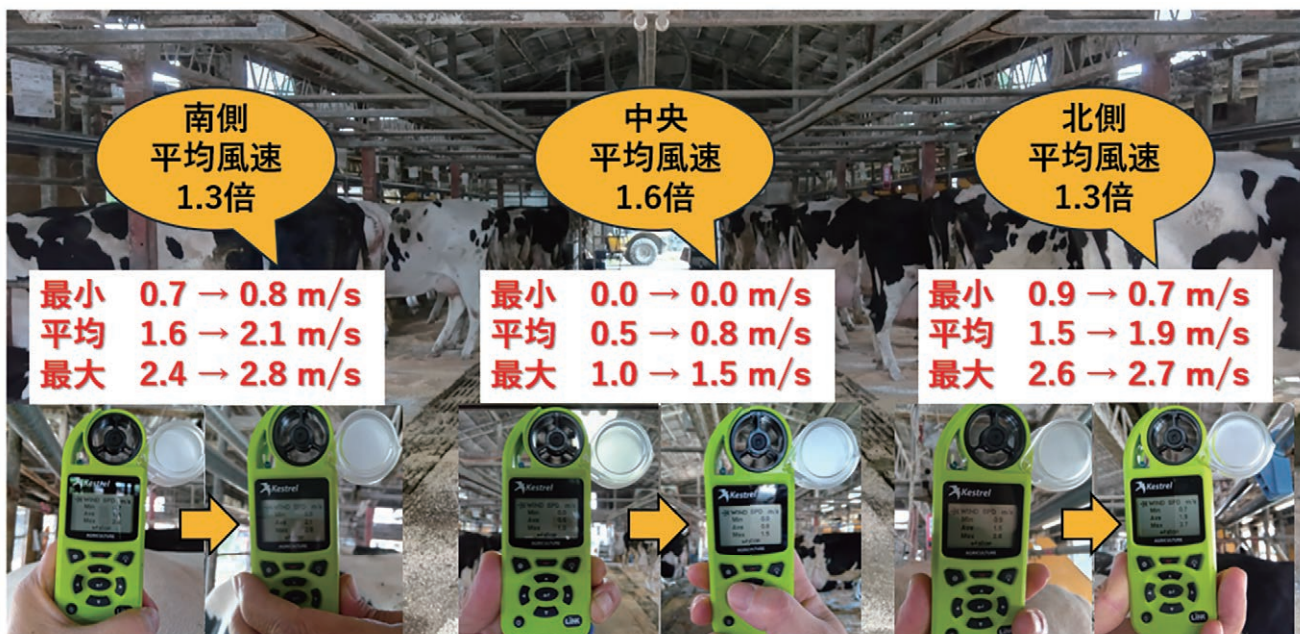
写真1 換気扇の清掃前後の風速への影響
