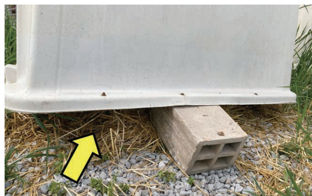
図3 ハッチの下にブロックを設置したハッチ内の換気対策 (イリノイ州の酪農場で撮影)
